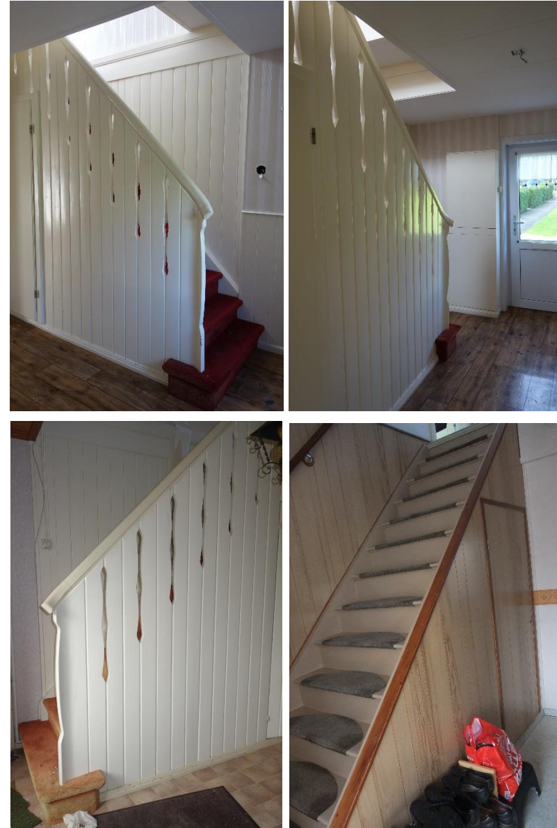
Trappenhuizen in Kolk 16 (boven), Kolk 20 (beneden links) en Prins Bernhardlaan 10 (rechts beneden). Bij deze laatste is de houten trapbalustrade verwijderd.
