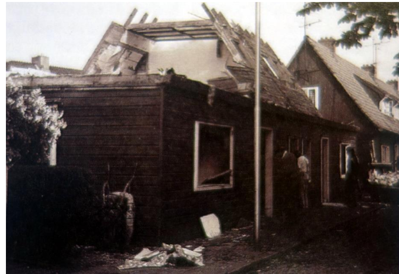
Sloop van het blokje woningen aan de Prins Bernhardstraat in De Kaag (bron: Alkmadders, 2012).
