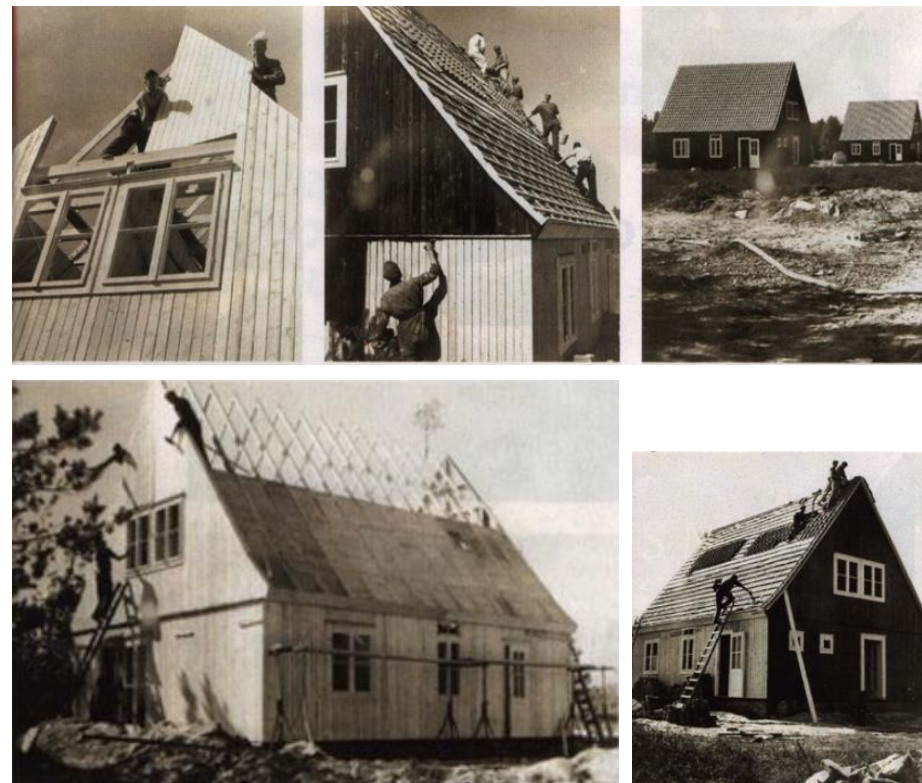
Oostenrijkse woningen in aanbouw, vermoedelijk in Wageningen. Illustraties afkomstig uit Eigen Huis Magazine , oktober 2006.
